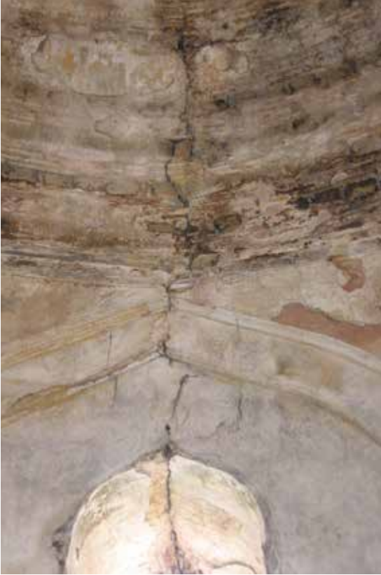
Hamam duvarında farklı oturmalarından kaynaklanan çatlak
