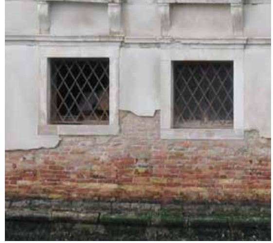
Nemin duvar içerisinde yükselmesi
