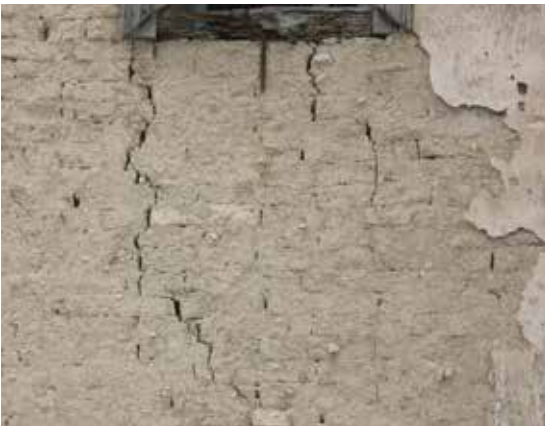
Düşey ve diyagonal çatlaklar
