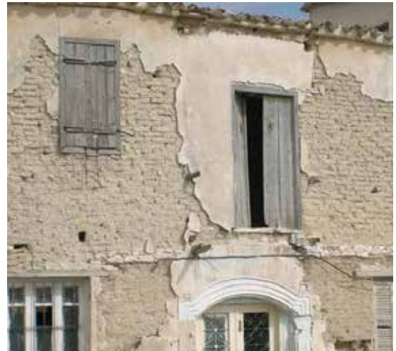
Sivada meydana gelen dökülmeler
