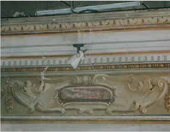
Deprem sonucu oluşmuş diyagonal çatlaklar
