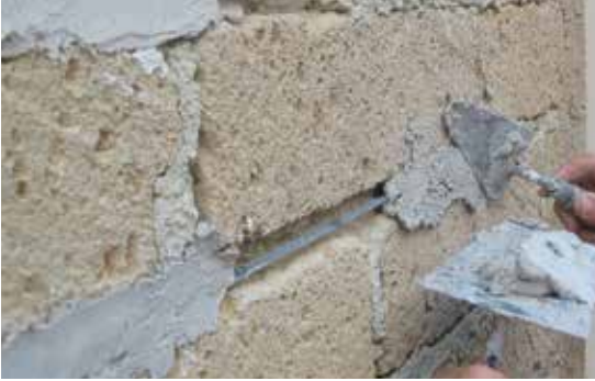
Karbon lifli fiber çubuk (MAsterBrace® Bar) ve MasterEmaco® S 285 TIX ile duvar derzinde yapılan güçlendirme uygulaması
