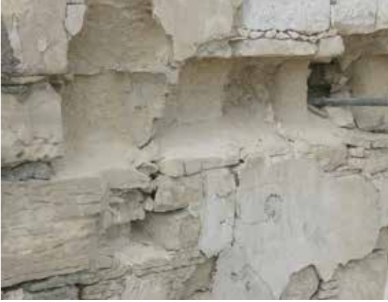
Duvarda yerel boşluklar
