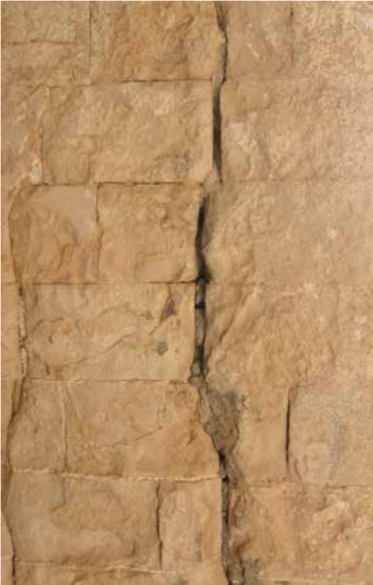
Duvar yüzeyinde meydana gelen çatlak
