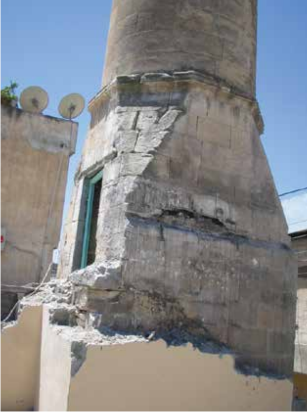
Gecekondu döşemesinin cami duvarına bağlanması sonucu minarede meydana gelen burulma hasarları
