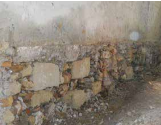
Duvar malzemesinde birleşme hataları
