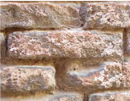
Derzlerin zaman içerisinde boşalması
