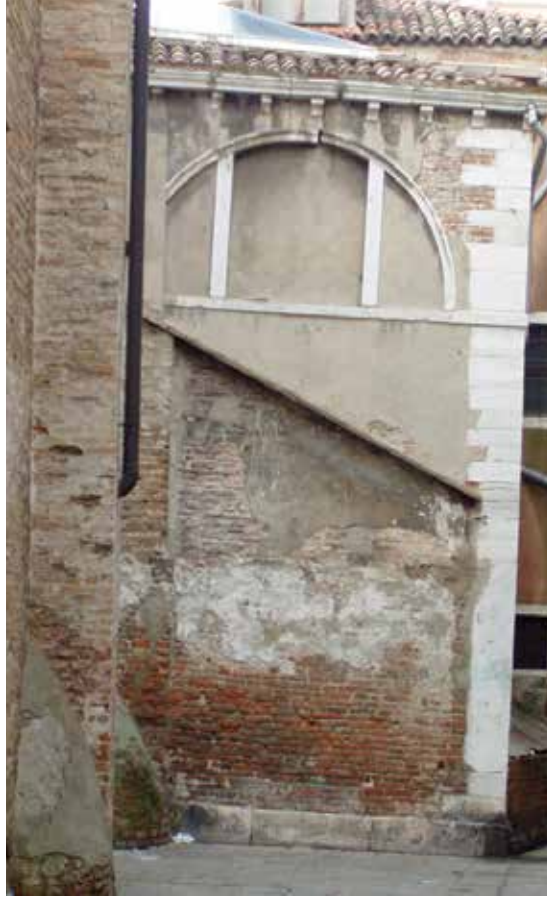
Zayıf zemin nedeni ile binanın dönmesi
