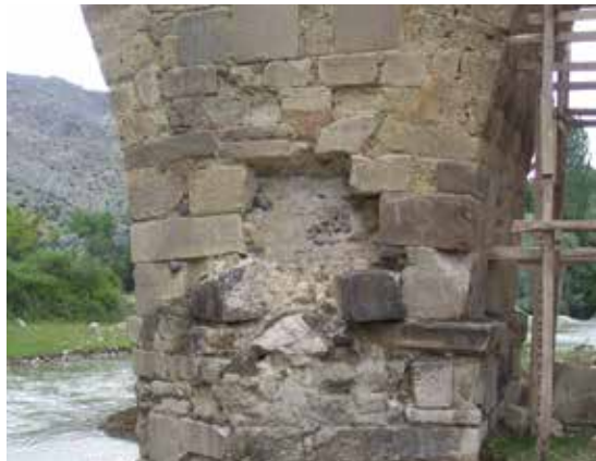
Köprü ayaklarında meydana gelen boşluklar
