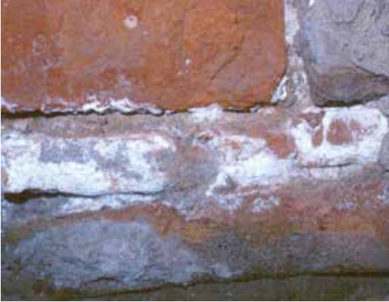
Tuğla yüzeyinde tuz kusması (çiçeklerime)
