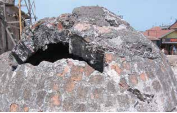
Küçük kubbede meydana gelen kısmi göçme
