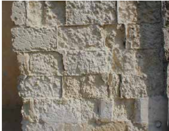
Duvarda süngersi bozulma
