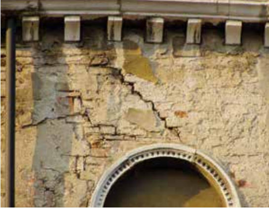
Duvar yüzeyinde diyagonal çatlaklar
