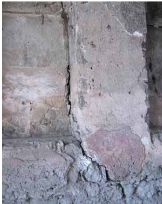
Oturmalara bağlı olarak oluşan çatlaklar
