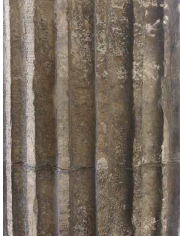
Atmosfer etkileri nedeni ile sütun yüzeyinde oluşan kirlenme
