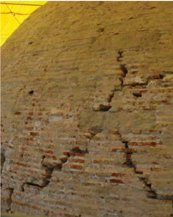
Cami kubbesinde meydana gelen diagonal çatlaklar
