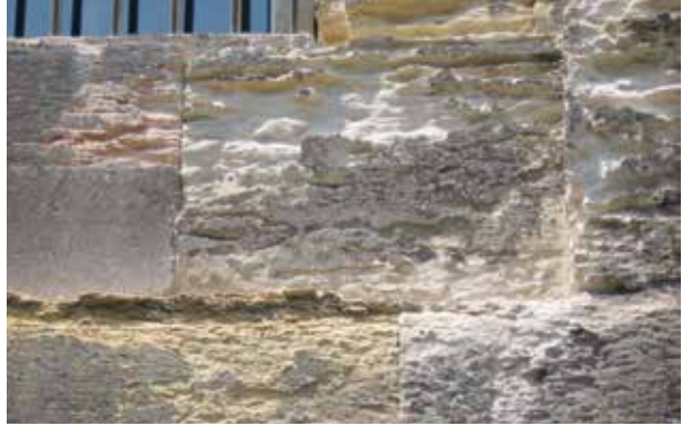
Donma-çözülme etkileri sonucu küfeki taşı yüzeyinde meydana gelen bozulmalar
